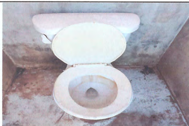
Foto 3: Sanitarios en mal estado.
