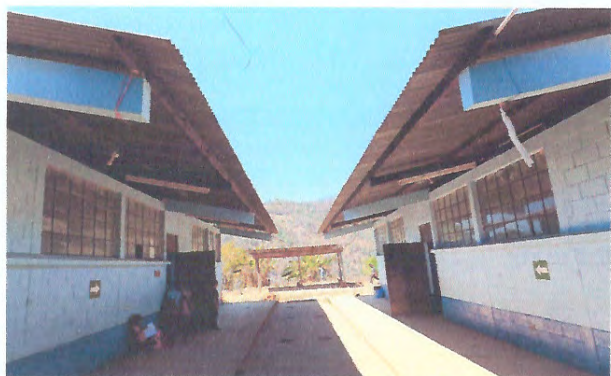
Foto 1: Estructura de techo con agujeros y deterioro de dos módulos.
